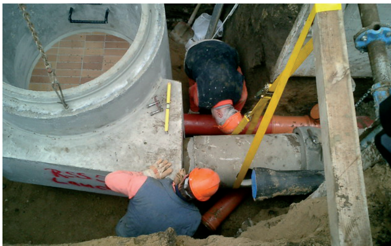
Anschluss der Rohrleitungen an den RSS Kombischacht
